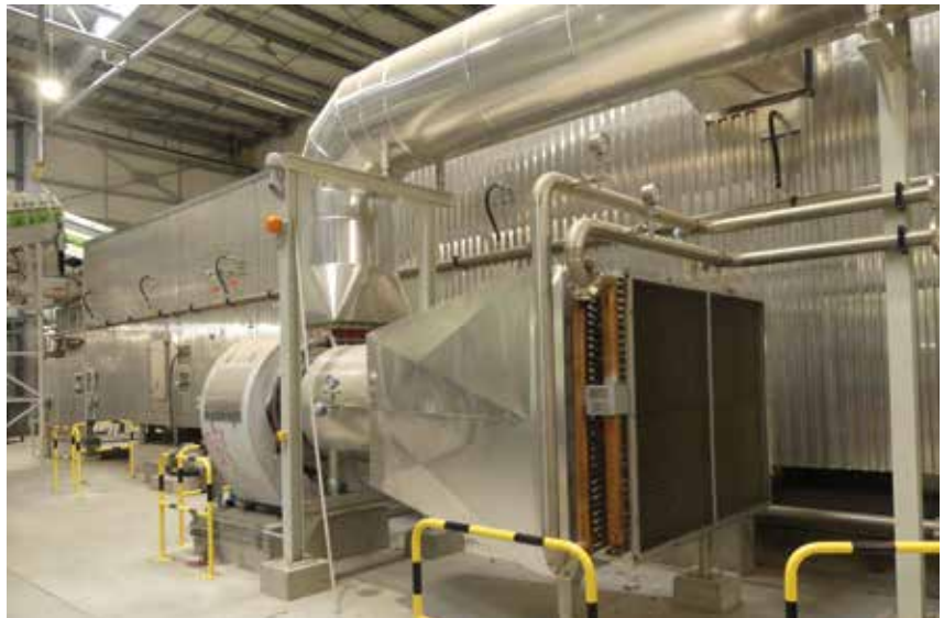
▲ Le sécheur permet d'adapter la qualité des CSR aux besoins des cimentiers.
