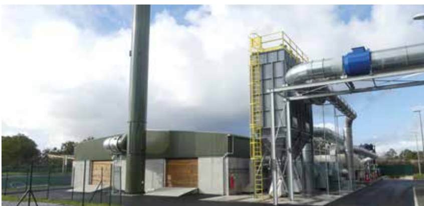
De multiples points d'aspirations permettent d'évacuer l'air vicié vers une installation de dépolluage et de lavage de l'air.
