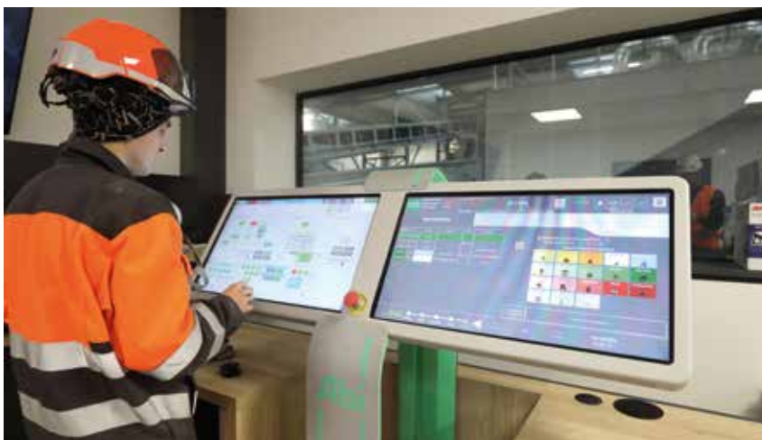
∧ L'exploitant supervise l'ensemble du pilotage de l'installation via des écrans tactiles.
